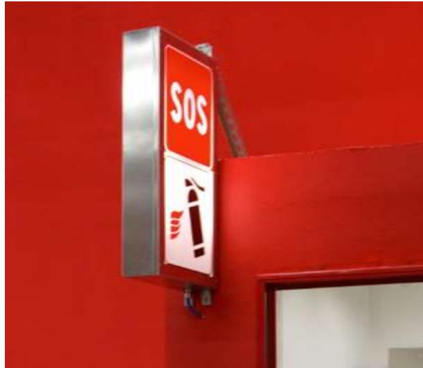
Figura 5: Esempio di cartello di segnalazione retro illuminato
